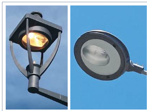
Figure 10 : Luminaires équipés de lampes dites « à décharge ».
