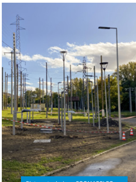
Plateau technique FORMAPELEC sur son site de Pont du Château (63)
